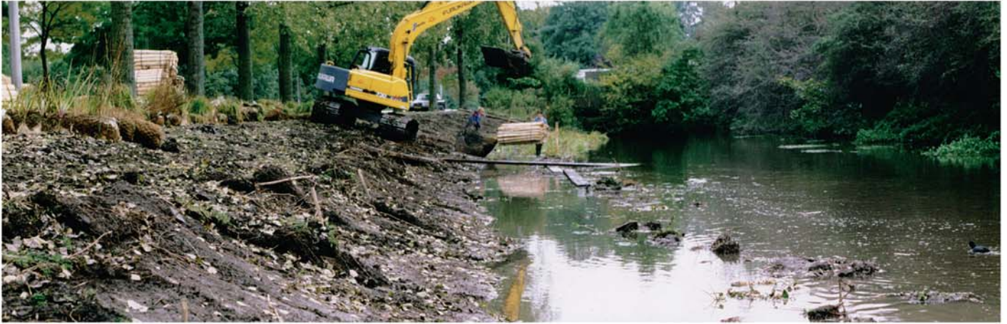
Octobre 1998 : Les terrassements sont achevés. Début de l'installation des fascines (boudins végétalisés) et géonattes.
